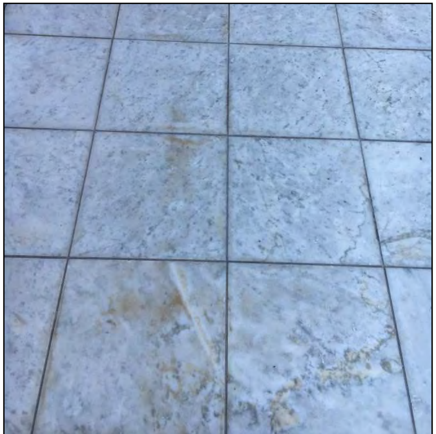
FOTO 6 - VISTA DELLO STATO DI CONSERVAZIONE DELLA PAVIMENTAZIONE ESTERNA
