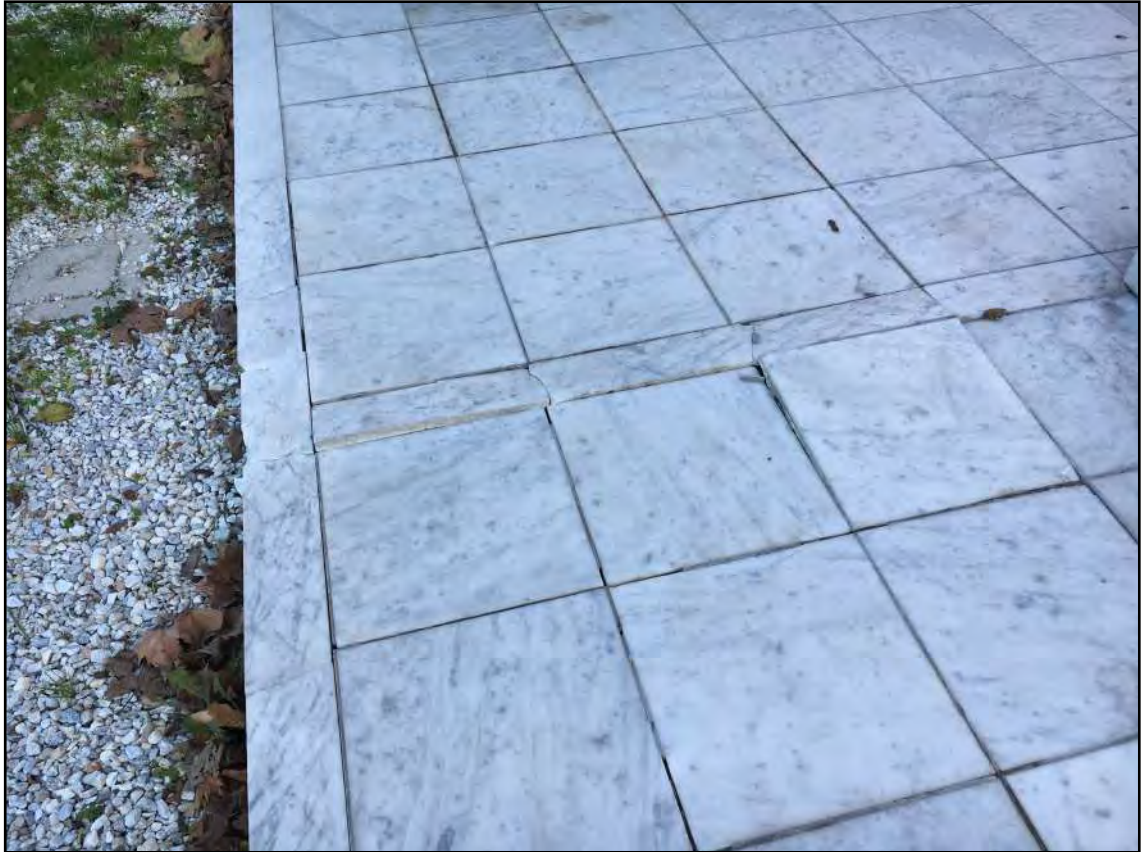
FOTO 5 - VISTA DEGLI ELEMENTI DANNEGGIATI DEL MARCIAPIEDE
