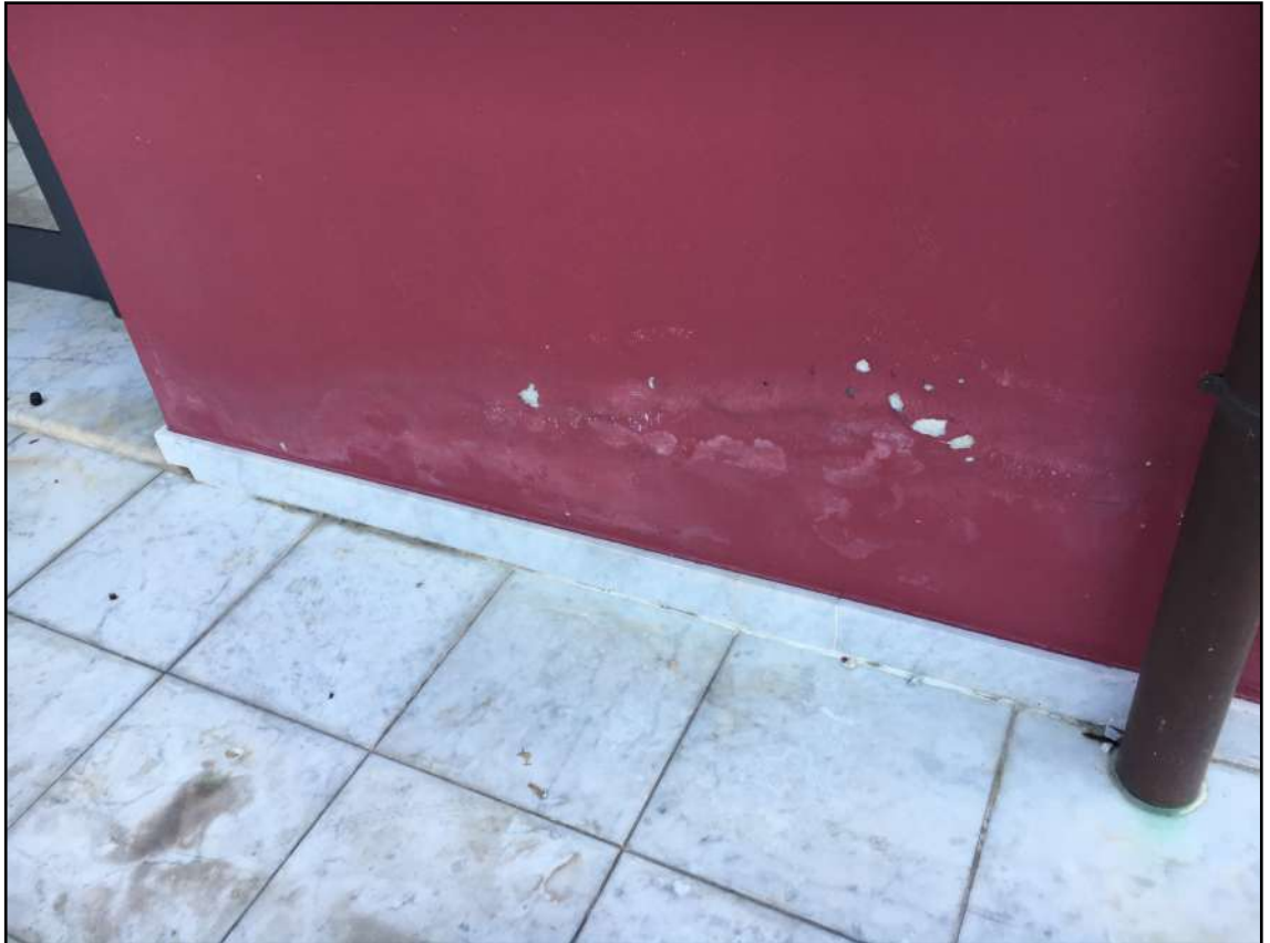
FOTO 3 - VISTA DEL DEGRADO DELL'INTONACO ESTERNO
