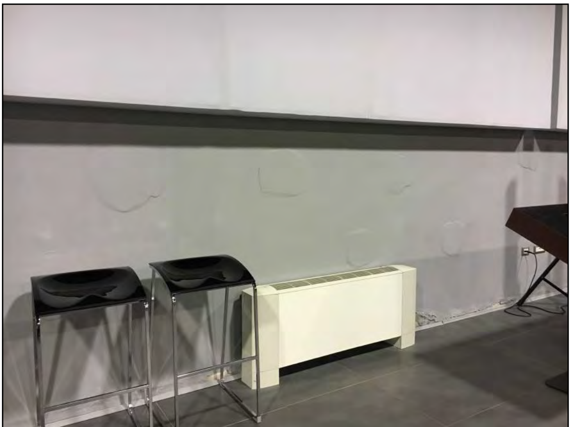
FOTO 4 - VISTA DEL DEGRADO DELL'INTONACO INTERNO
