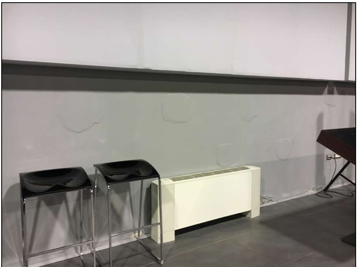
FOTO 4 - VISTA DEL DEGRADO DELL'INTONACO INTERNO
