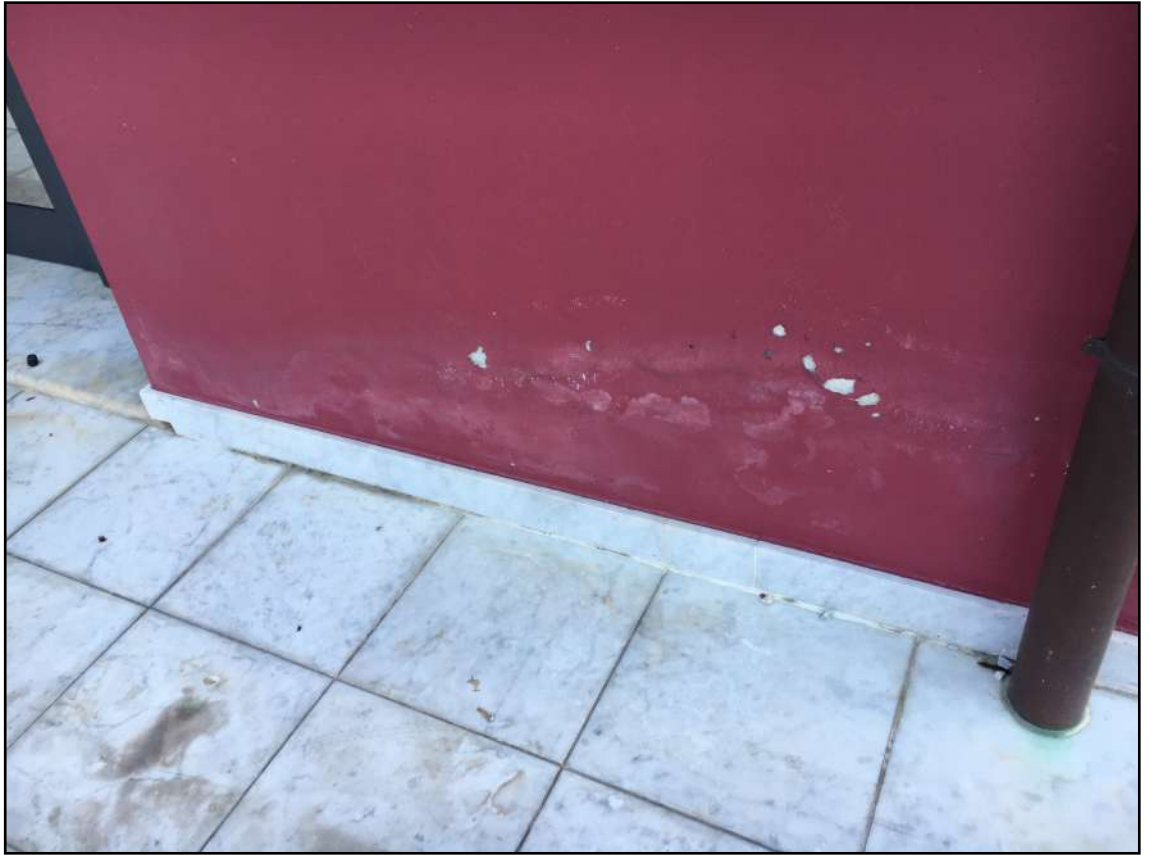
FOTO 3 - VISTA DEL DEGRADO DELL'INTONACO ESTERNO
