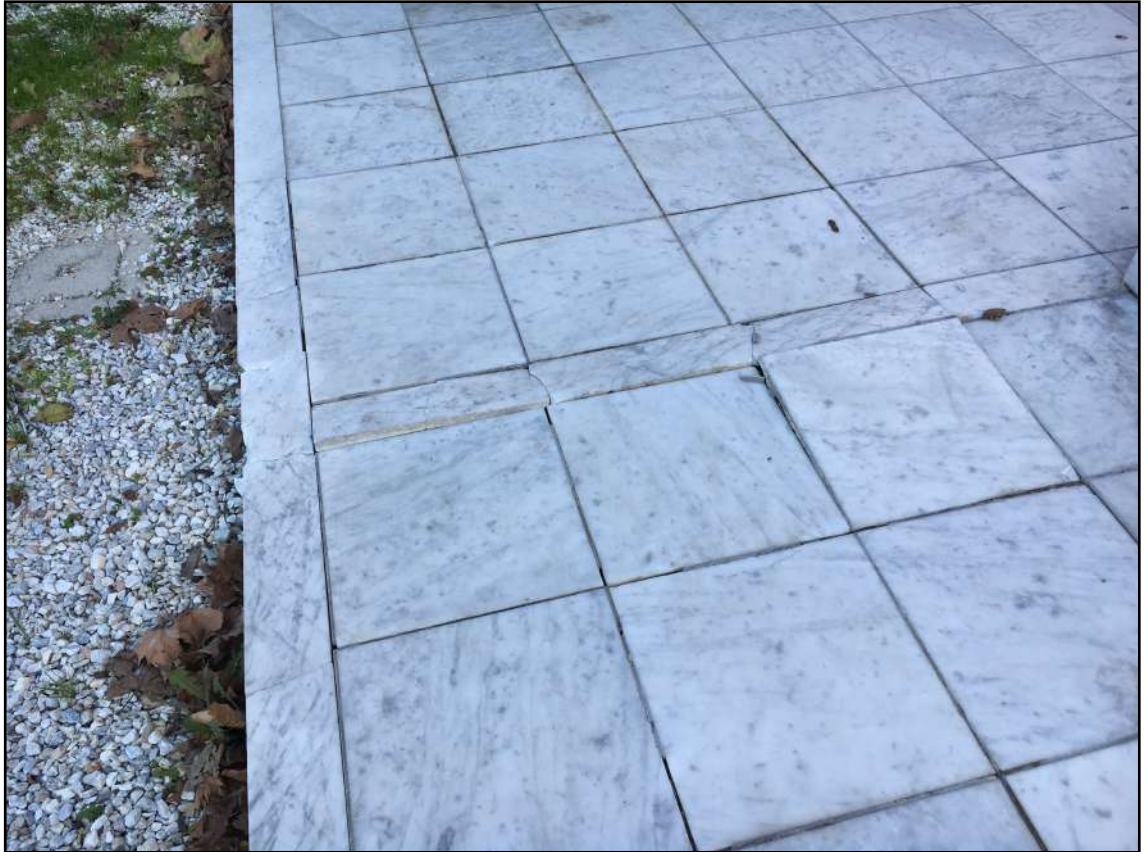
FOTO 5 - VISTA DEGLI ELEMENTI DANNEGGIATI DEL MARCIAPIEDE
